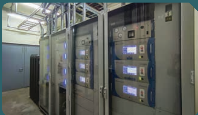
^ Ruang CEMS Analyzer di pembangkit listrik AMMAN.
